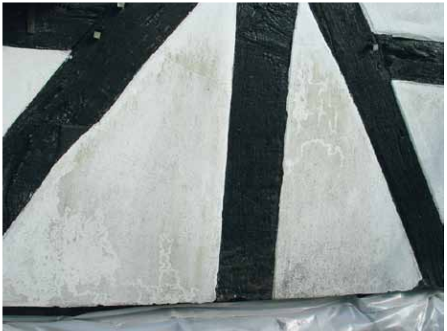
Bild 7: Fassade mit geschädigtem Außenputz
